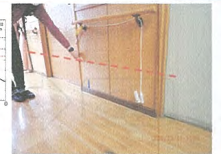
浸水痕跡 床上0.4m (2023年12月21日撮影)
